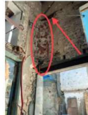
Les aléas d'un chantier dans l'ancien, avec la découverte d'assemblages faits de brique et de broc. © C.B.
