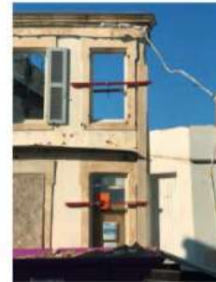
Le chantier de rénovation a très vite été confronté des fragilités dans la structure même du bâtiment. © C.B.
